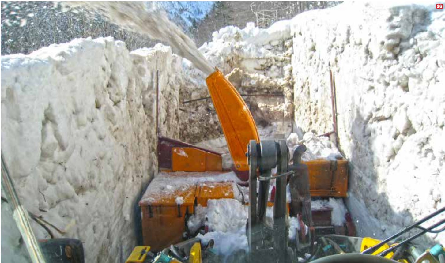
26 Räumung Plöckenpassstraße. (Foto: LK Kötschach-Mauthen, Pranter) |
