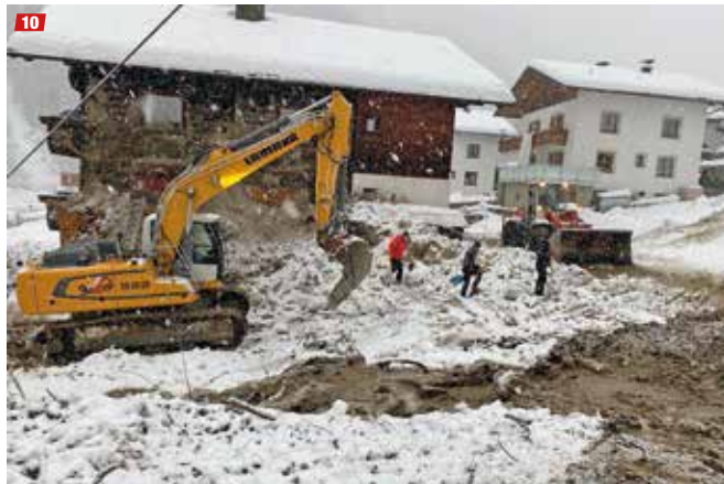
10 Aufräumarbeiten nach der Nassschneelawine mit Schlamm in Hopfgarten. (Foto: Gemeinde Hopfgarten, 06.12.2020) |
